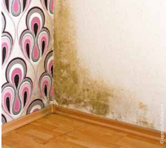
Schimmelbefall im Wohnbereich
