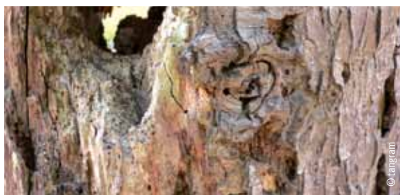
Holzschäden durch Schädlinge
