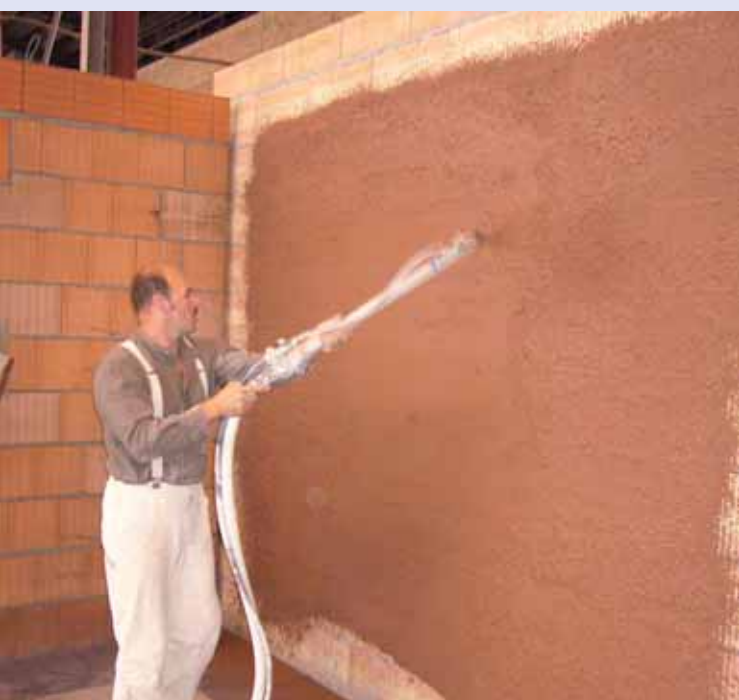
Lehmputz auf Poroton – keine feuchtesperrende Beschichtung
