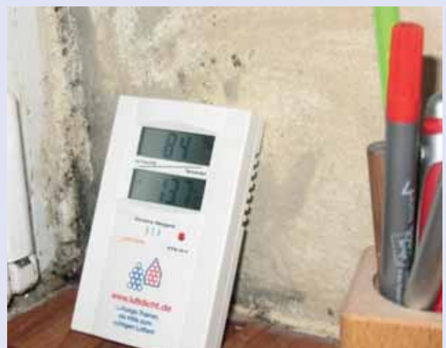
Schadstoffuntersuchungen / Schimmel auf Außenwand
