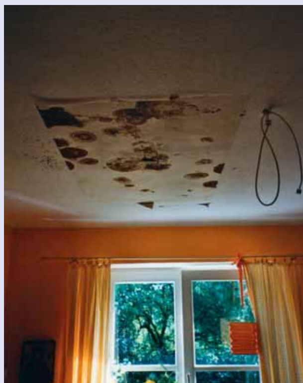
Schimmelbefall unter Tapete
