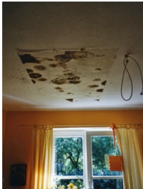
Bild 66: Methner, Klaus - Schimmelbefall unter Tapete
