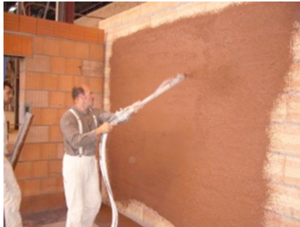
Bild 45: Pilosith -Lehmputz auf Poroton - keine feuchtesperrende Beschichtung
