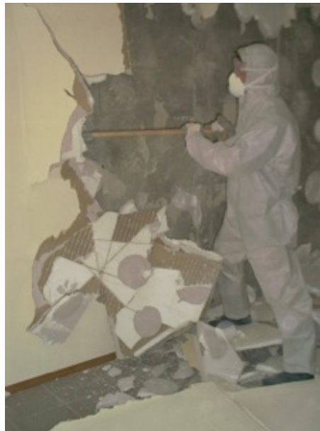
Bild 73: Methner, Klaus: Arbeitsschutz bei Schimmelsanierung Dämmschaden mit Gipskartonplatten auf Betonkellerwand
