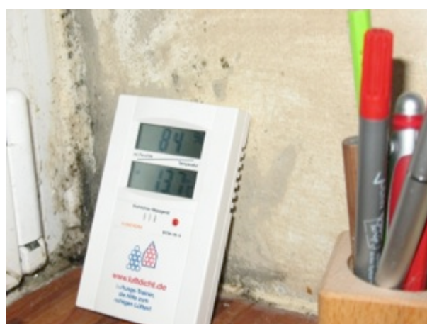
Bild 03: IQUH Schadstoffuntersuchungen/Schimmel auf Außenwand
