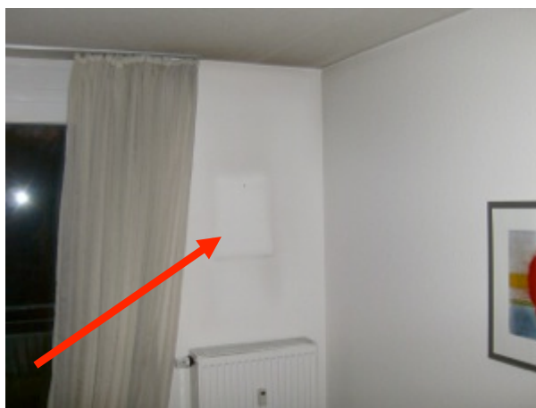
Bild 04: IQUH Untersuchungen – Fogging durch Schadstoffe
