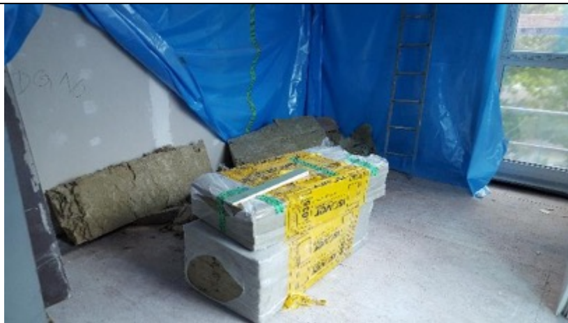
Rest Kontamination der Raumluf durch alte Baustoffe
