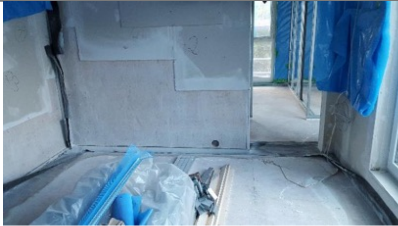
Alkalisierung der betroffenen Oberflächen
